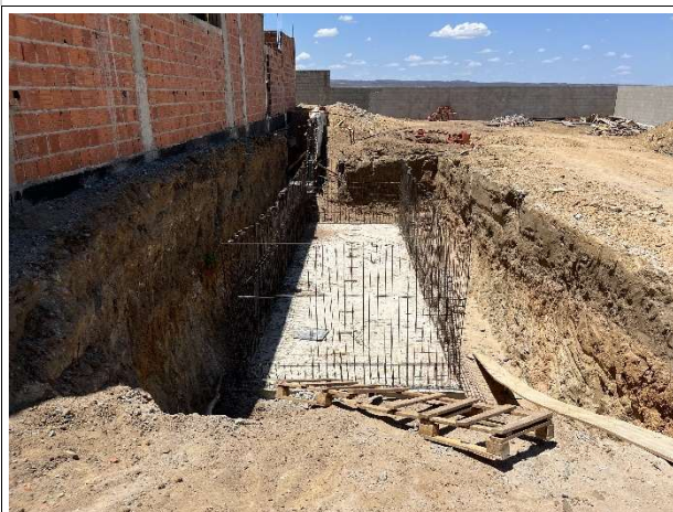
Foto 7 – Cisterna (instalações hidrossanitárias)
