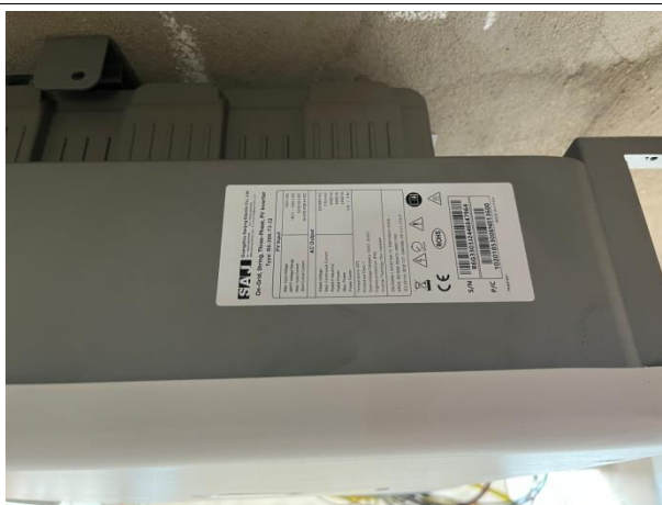
Fig. 13 – Inversor fotovoltaico conforme projeto
