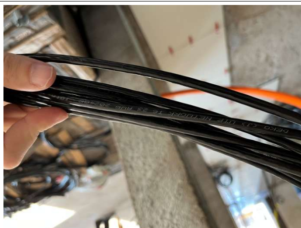
Fig. 13 – Instalações de cabeamento estruturado
