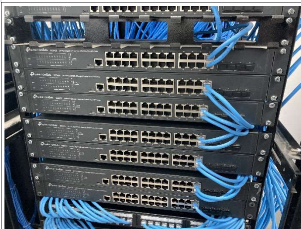
Fig. 13 – Switches (instalações de lógica)
