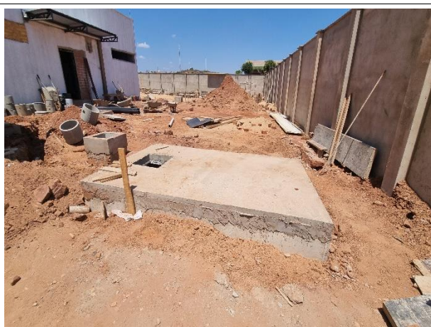
Fig. 13 – Cisterna (instalações hidráulicas)
