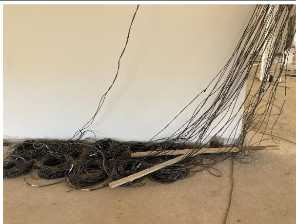
Fig. 9 – Instalações de cabeamento estruturado e CFTV
