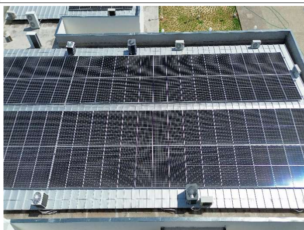
Fig. 14 – sistema fotovoltaico e ar condicionados
