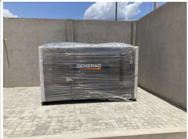
Fig. 16 – grupo gerador cabinado
