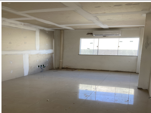
Fig. 7 – parede/forro de drywall e ar condicionado
