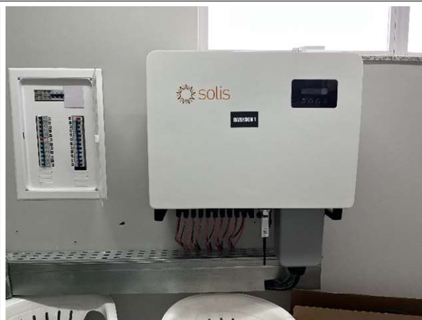
Fig. 16 – inversor do sistema fotovoltaico
