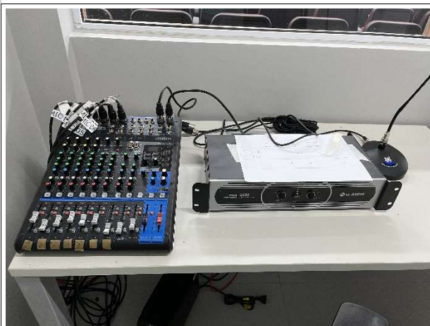
Fig. 13 – instalações de sonorização
