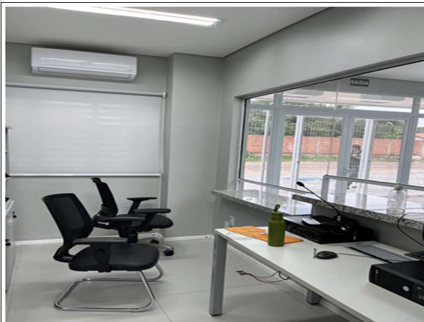
Fig. 7 – instalações de sonorização e climatização
