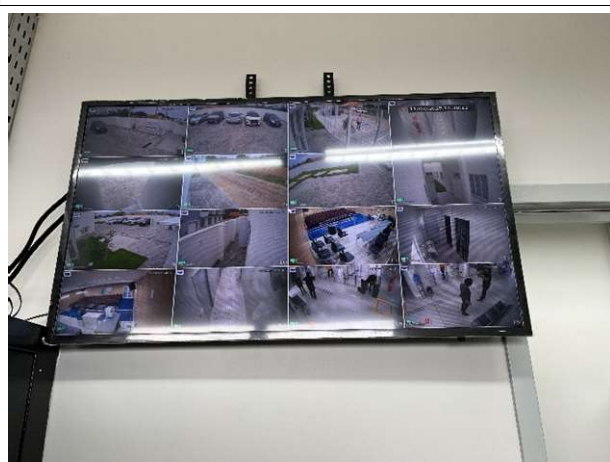
Fig. 14 – instalações de CFTV
