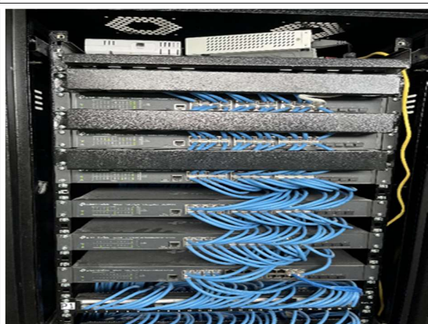
Fig. 12 – instalações de cabeamento estruturado
