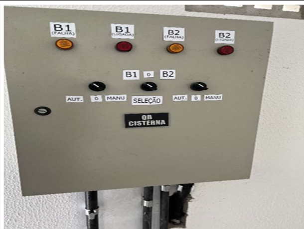
Fig. 18 – quadro de bombas (instalação hidráulica)
