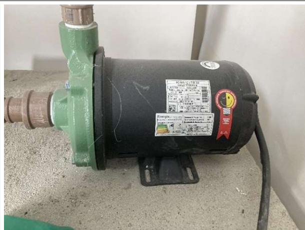
Fig. 18 – bomba (instalação hidráulica)
