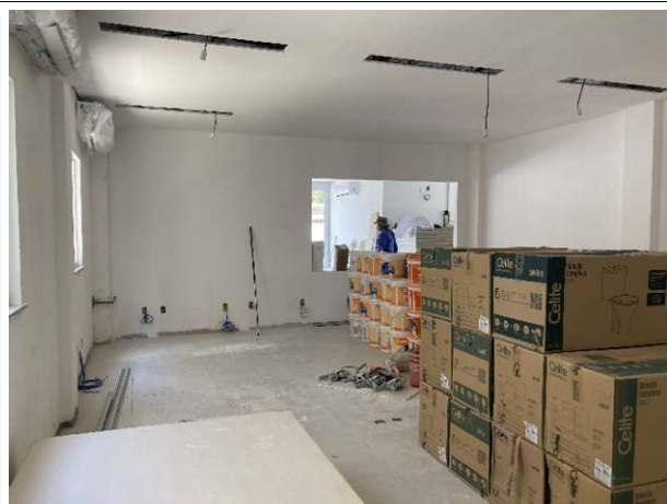
Fig. 6 – instalações lógicas, elétricas e frigorígenas
