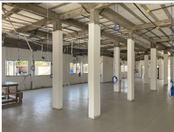
Fig. 5 – instalações lógicas, elétricas e frigorígenas
