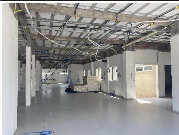
Fig. 4 – instalações lógicas, elétricas e frigorígenas
