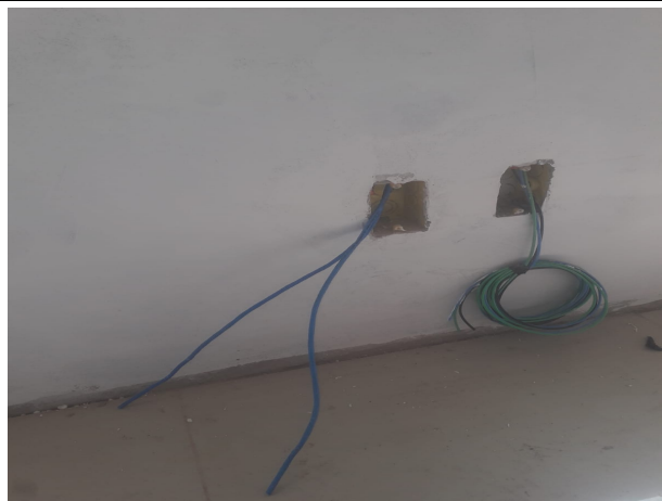
Fig. 7 – instalações lógicas e elétricas
