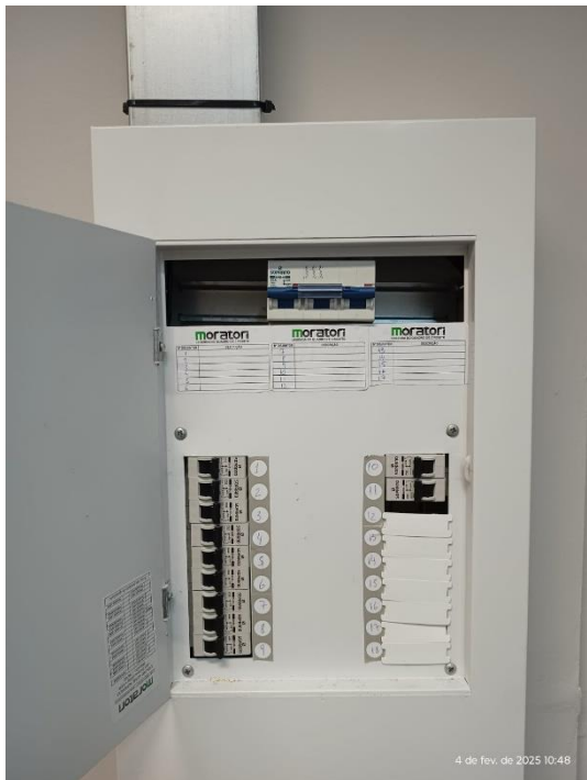
Fig. 6 – Quadro de distribuição de energia.
