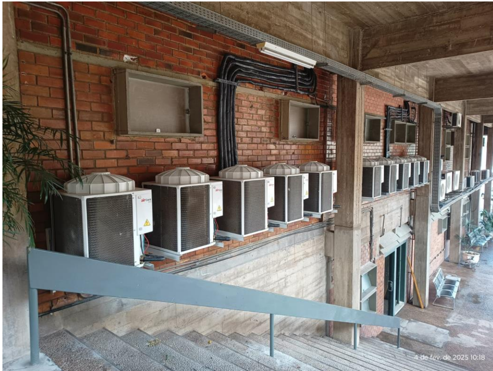
Fig. 9 – Instalações para climatização: Todas as condensadoras instaladas.
