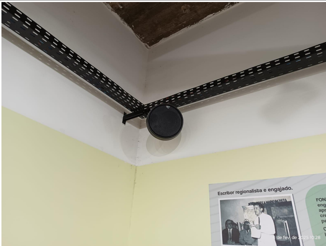
Fig. 8 – Instalações de sonorização.
