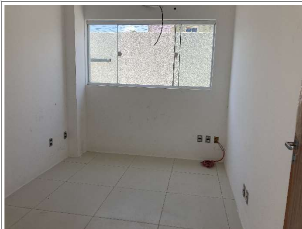
Fig. 7 – instalações elétricas e lógicas
