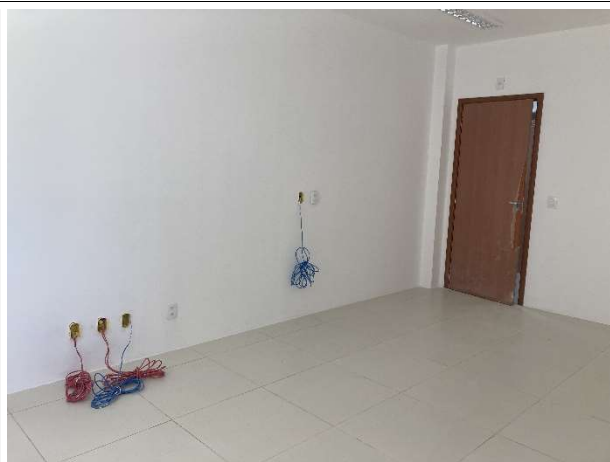
Fig. 10 – instalações de cabeamento estruturado
