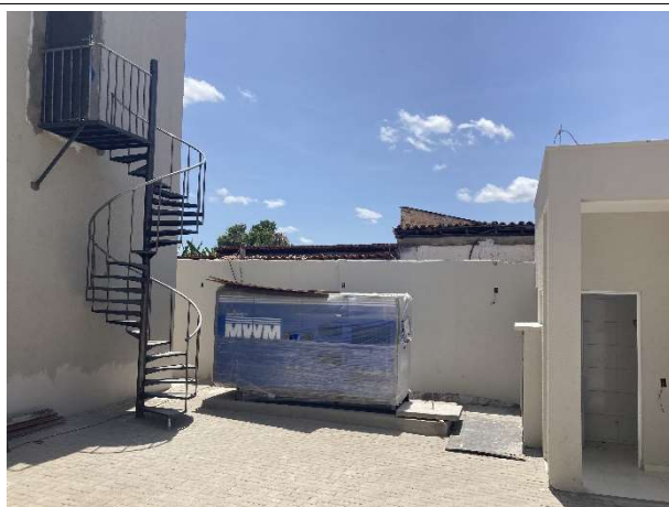
Fig. 7 – grupo gerador e escada metálica (diversos)
