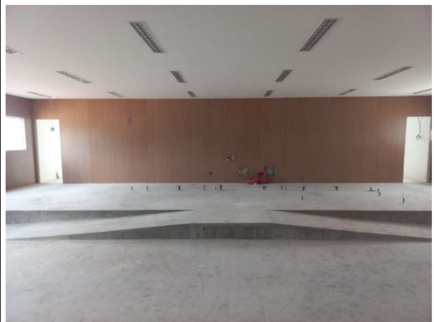
Fig. 16 – revestimentos e instalações de sonorização
