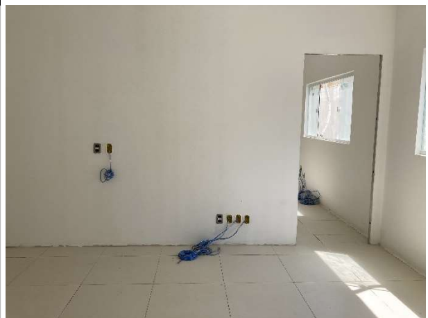
Fig. 10 – instalações lógicas e esquadrias de vidro
