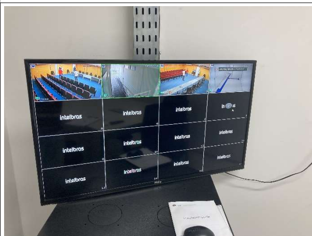
Fig. 14 – Instalações de CFTV do 1º Pavimento
