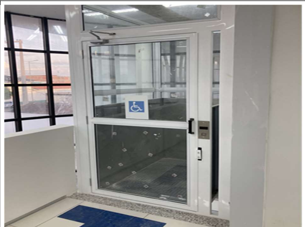
Fig. 18 – Plataforma elevatória (diversos)
