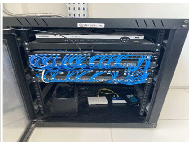
Fig. 9 – Instalações de cabeamento estruturado
