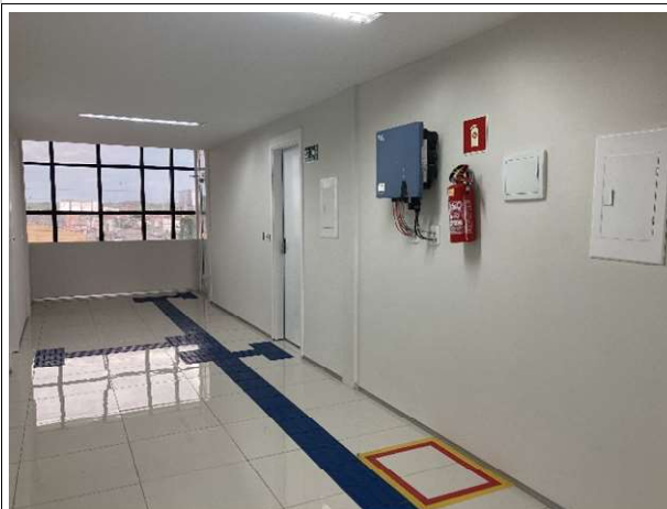
Fig. 25 – Inversor do sistema fotovoltaico
