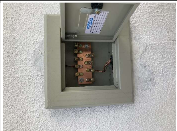
Fig. 24 – Quadro de equipotencialização (SPDA)
