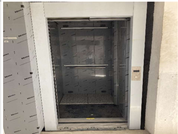
Fig. 10 – cabine do elevador
