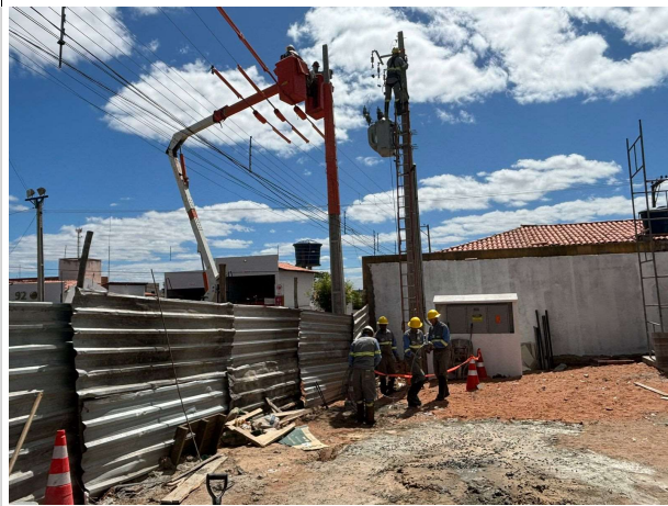
Fig. 3 – interligação da subestação aérea
