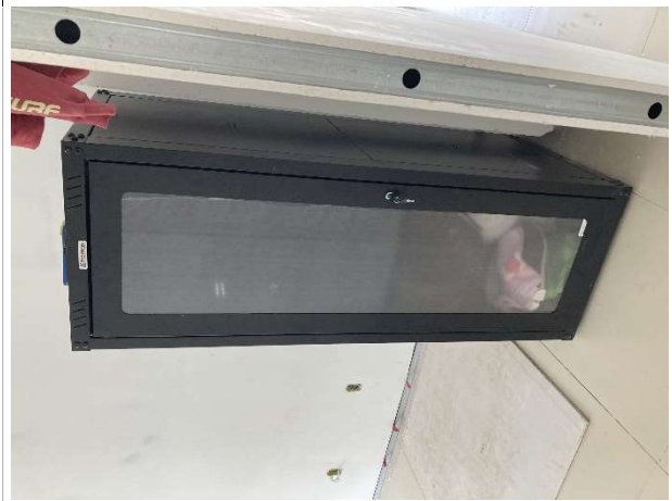
Fig. 16 – rack de cabeamento estruturado
