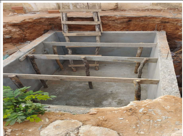
Fig. 18 – instalações hidrossanitárias (tanque séptico)
