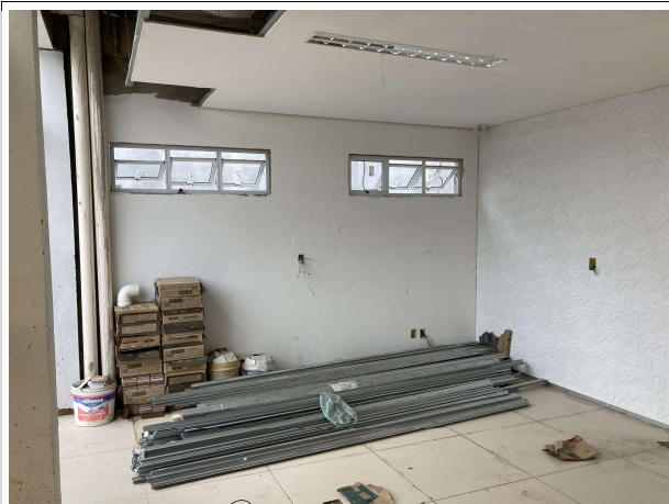
Fig. 5 – pintura e revestimentos da entrada do Fórum
