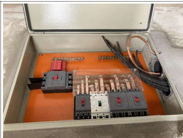
Fig. 14 – quadro geral de baixa tensão
