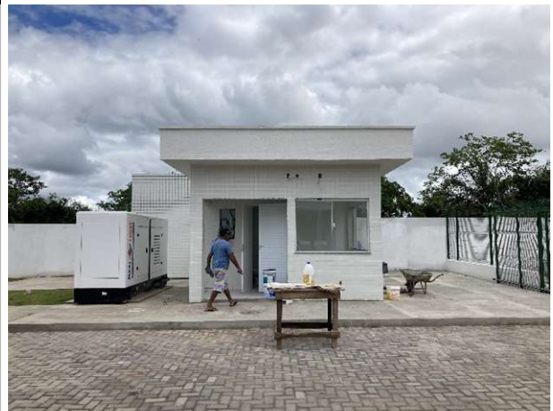
Fig. 2 – guarita e gerador
