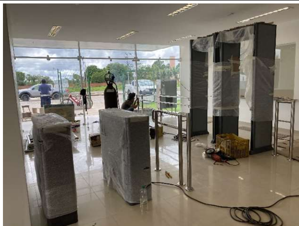
Fig. 3 – instalações de controle de acesso
