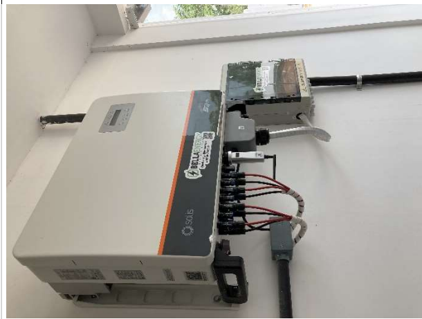
Fig. 9 – inversor do sistema fotovoltaico
