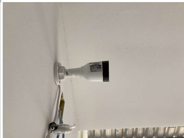
Fig. 11 – instalações de CFTV
