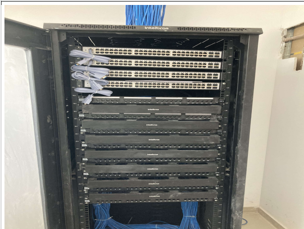
Fig. 11 – equipamentos de cabeamento estruturado
