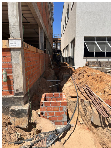
Fig. 4 – Instalações sanitárias (SUGESQ)
