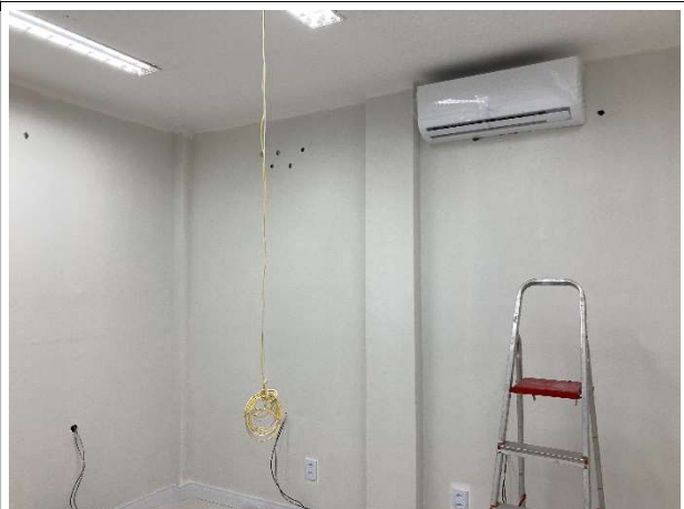
Fig. 6 – Instalações elétricas e ar condicionado
