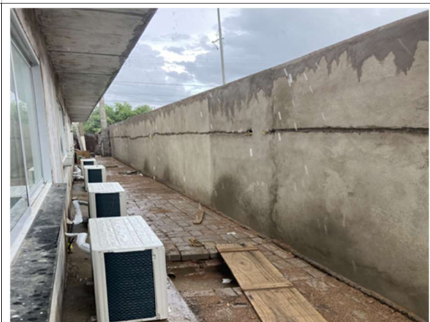
Fig. 14 – Unidades externas de ar condicionado
