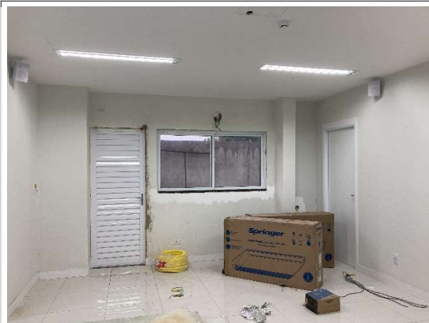
Fig. 5 – Portas, janelas e instalação de sonorização
