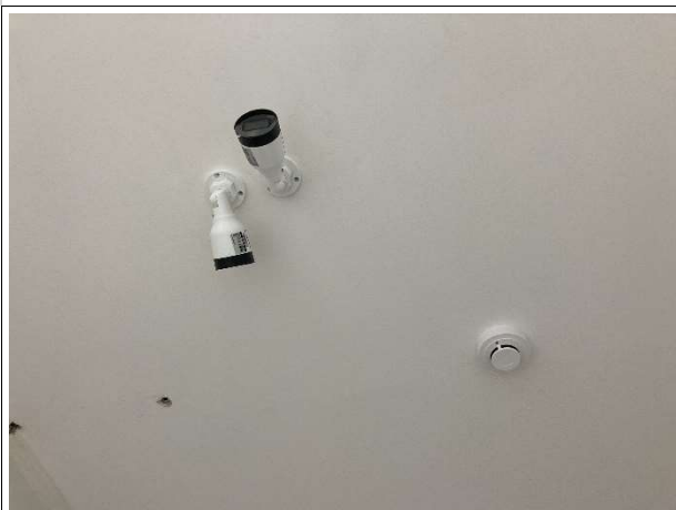
Fig. 7 – CFTV e instalações de combate a incêndio
