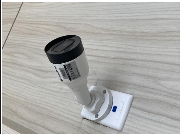
Fig. 12 – Instalações de CFTV
