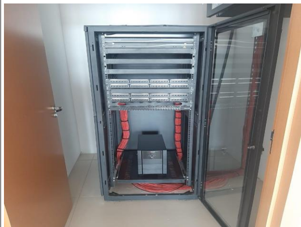
Fig. 11 – Instalações de cabeamento estruturado
