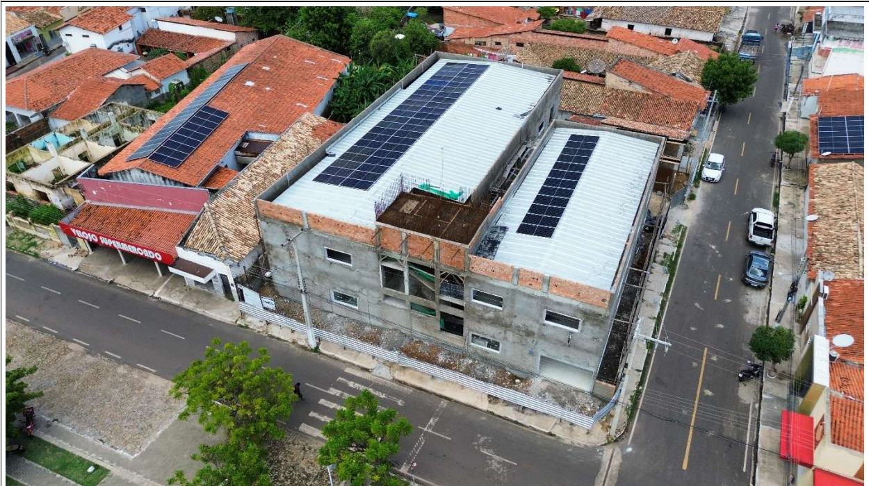
Fig. 2 – Vista aérea da obra, com execução da cobertura e do sistema fotovoltaico
