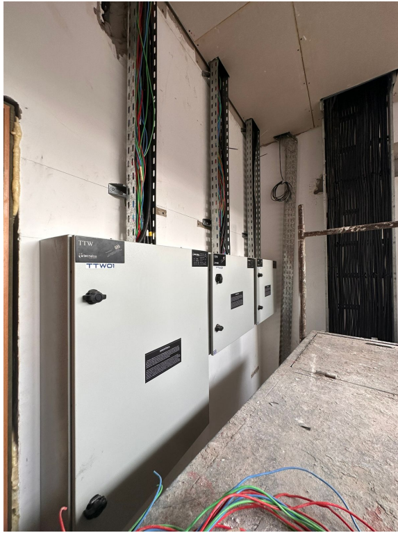
Fig. 9 – Quadros de energia EJUD
