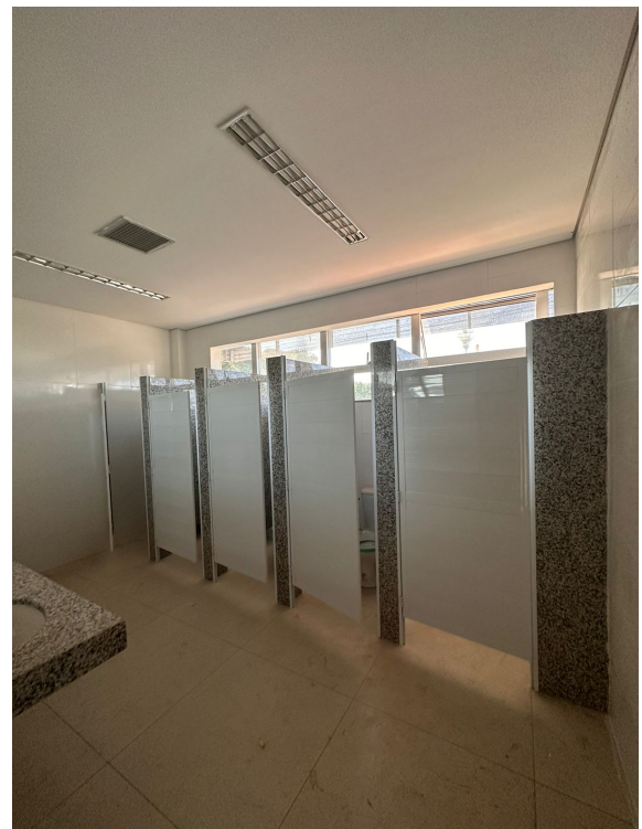
Fig. 32 – Portas alumínio banheiros Corregedoria
