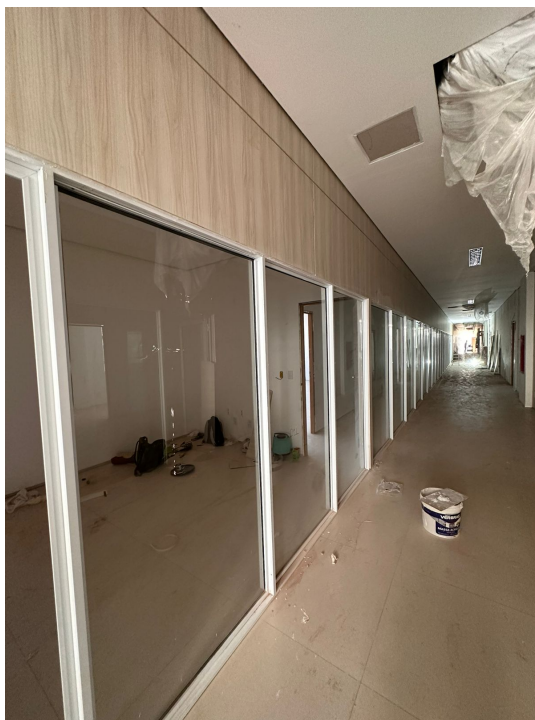
Fig. 35 – MDF e esquadrias de alumínio Corregedoria
