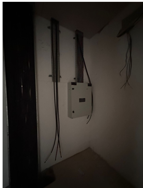
Fig. 36 – Quadro de energia Corregedoria
