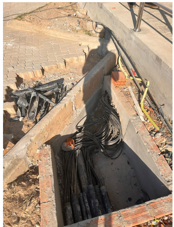
Fig. 24 – Cabeamento elétrico Corregedoria
