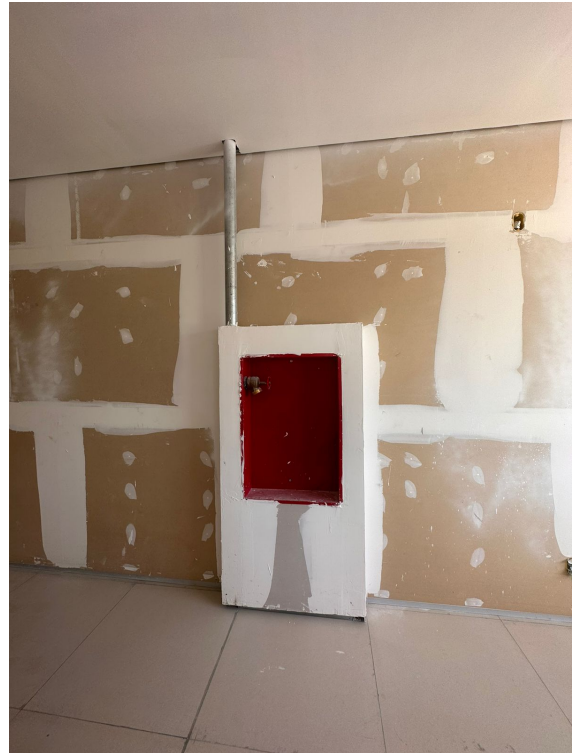
Fig. 18 – Instalações de incêndio EJUD
