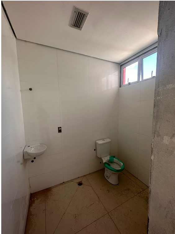
Fig. 17 – Instalações sanitárias EJUD
