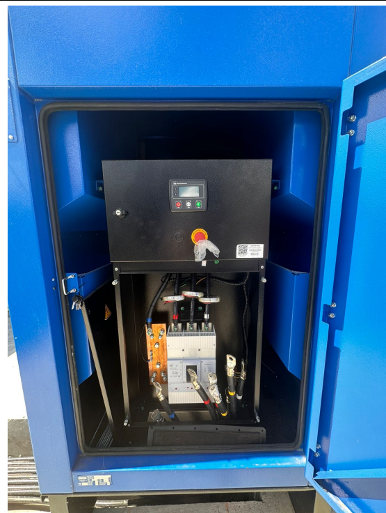
Fig. 48 – Instalação elétrica Geradores
