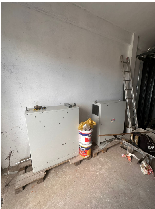
Fig. 47 – Quadros elétricos Subestação
