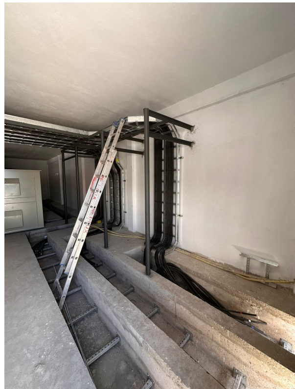
Fig. 46 – Instalação elétrica Subestação
