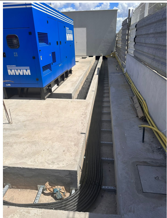
Fig. 44 – Instalação elétrica Geradores Subestação
