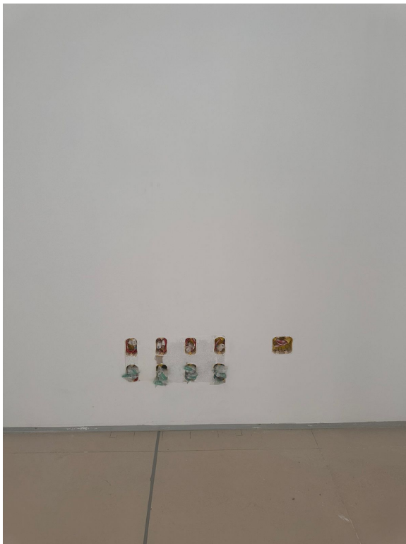
Fig. 33 – Instalações elétricas e lógica Corregedoria
