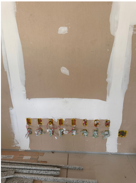
Fig. 15 – Instalações elétricas e lógica EJUD
