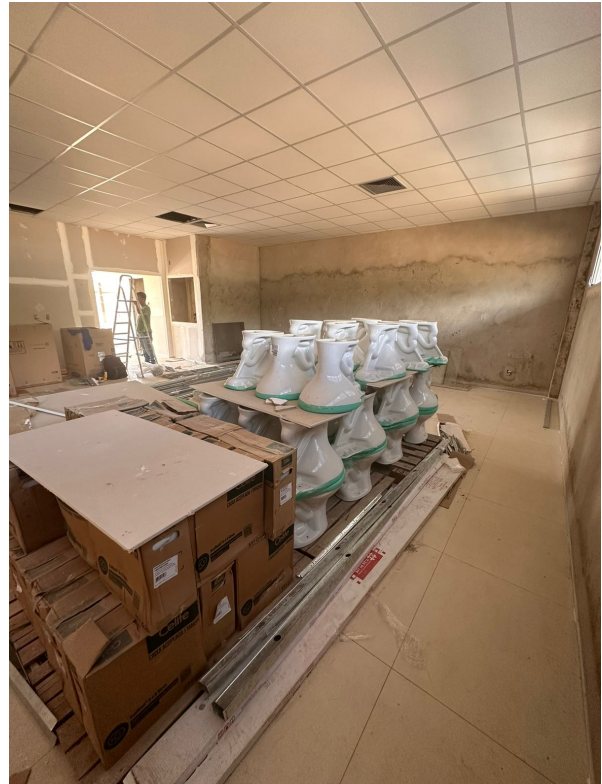
Fig. 30 – Aparelhos sanitários Corregedoria
