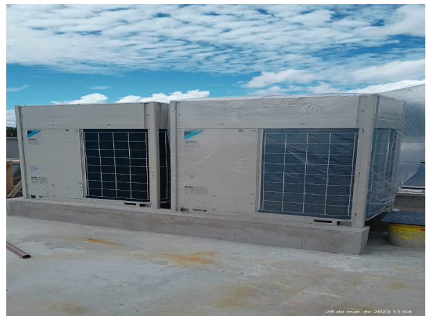
Fig. 20 – equipamentos do sistema de climatização
