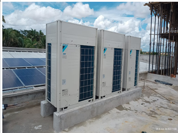
Fig. 19 – equipamentos do sistema de climatização
