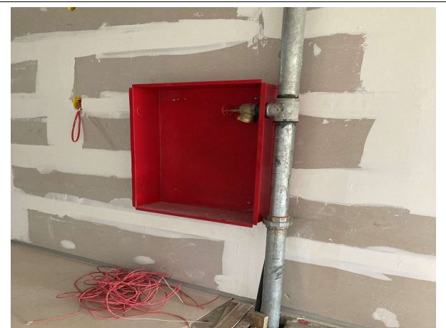
Fig. 12 – instalação de combate a incêndio
