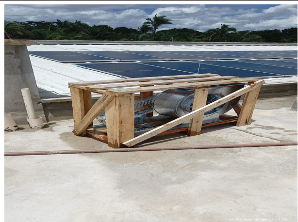
Fig. 24 – equipamentos do sistema de exaustão
