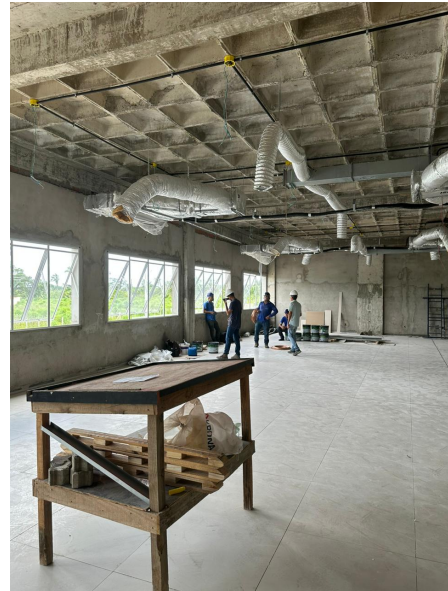
Foto 2 – Instalações de ar, exaustão e ventilação EJUD
