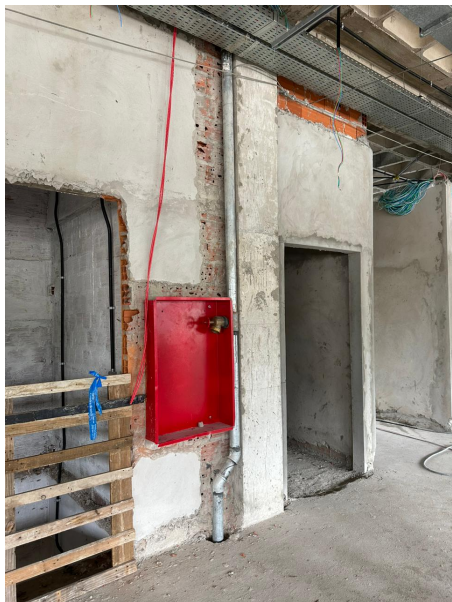
Foto 23 – Instalações de combate a incêndio Corregedoria
