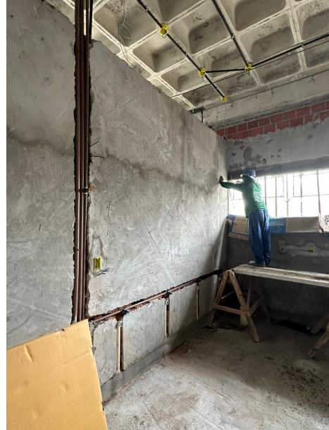
Foto 22 – Instalações hidro sanitárias banheiros Corregedoria
