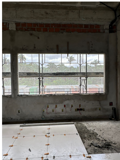
Foto 16 - Instalações elétricas e de lógica Corregedoria
