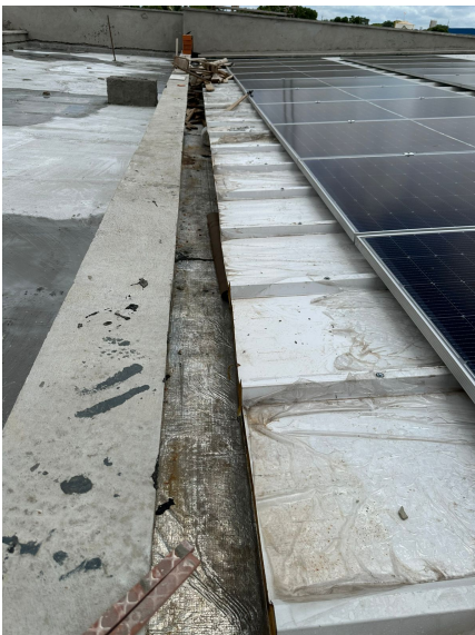
Foto 11 – Calhas impermeabilizadas EJUD
