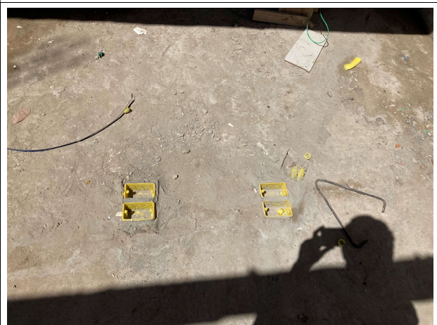
Fig. 12 – tubulação das instalações da catraca
