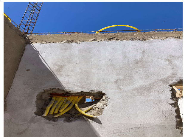
Fig. 10 – tubulação do quadro de distribuição
