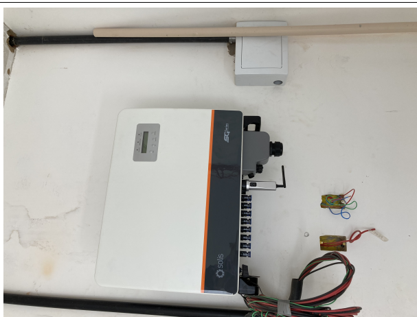
Fig. 11 – inversor do sistema fotovoltaico
