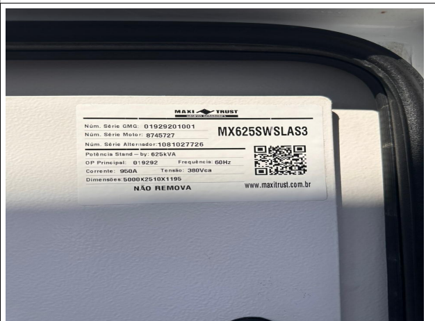
Fig. 12 – Grupo gerador do Auditório
