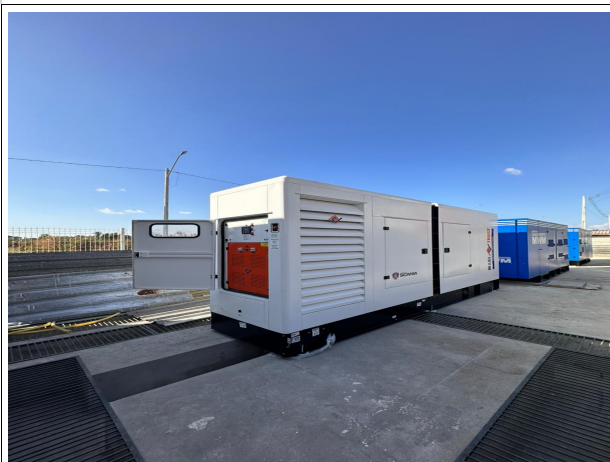
Fig. 11 – Grupo gerador do Auditório
