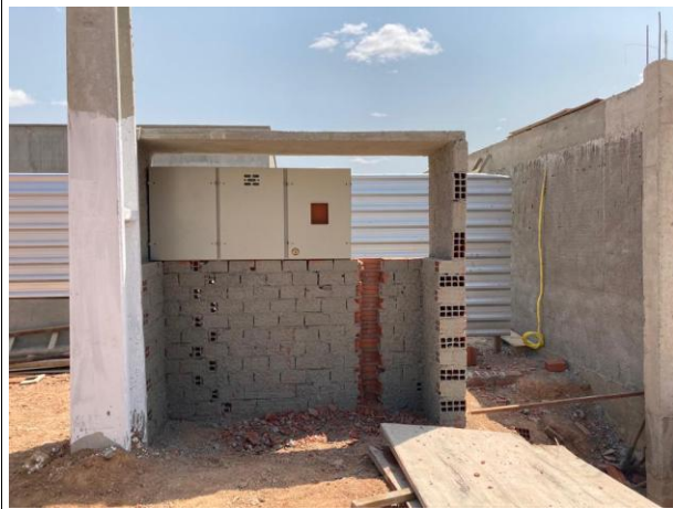
Fig. 15 – Quadro de medição
