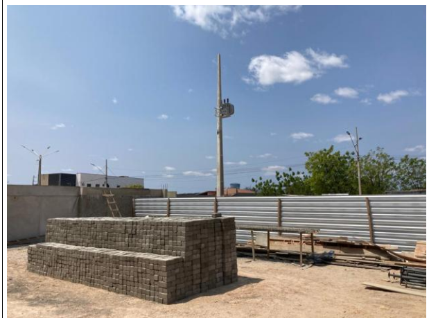
Fig. 6 – Subestação e pavimento intertravado
