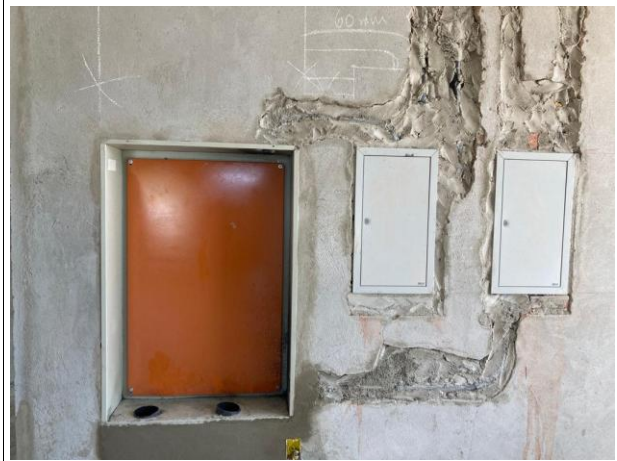
Fig. 10 – Quadros de instalações elétricas
