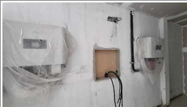
Fig. 13 – Inversor do sistema fotovoltaico
