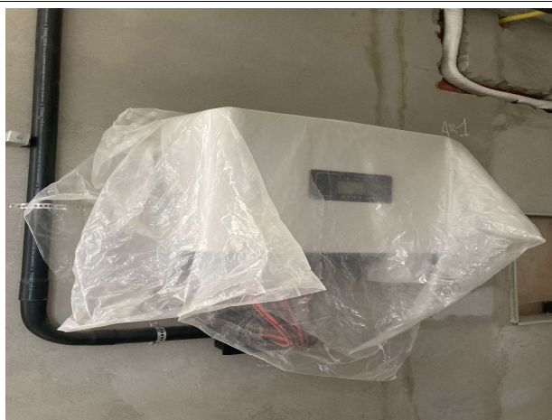
Fig. 13 – Inversor do sistema fotovoltaico
