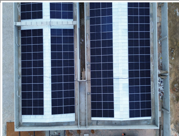
Fig. 17 – Sistema fotovoltaico e HVAC
